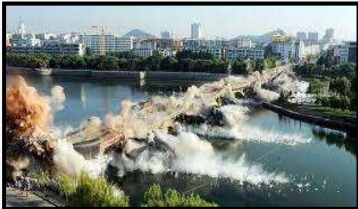
Разрушение мостов, дорожных покровов
